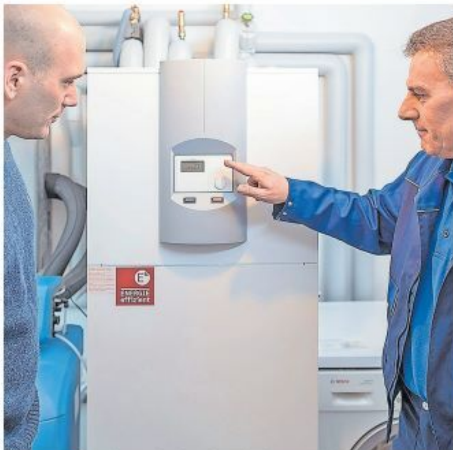
Der Heizungsbauer kann Auskunft zu den Anforderungen an die Wärmequelle geben.
