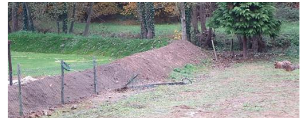
Verwallung / Mauern BCE, www.hochwassermanagement.rlp-umwelt.de
